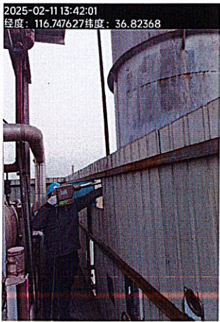
3#燃气轮机组排气筒（DA018）
