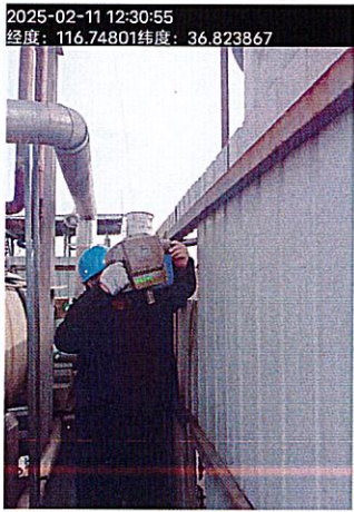
2#燃气轮机组排气筒（DA002）
